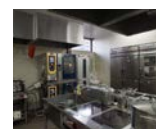
電化 厨房 機器
