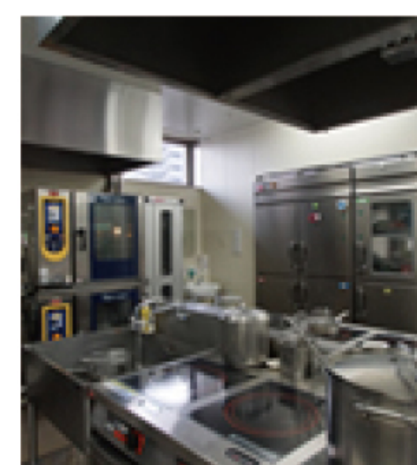
電化厨房機器
