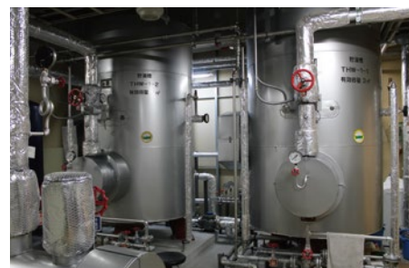
水温を55度で維持できる貯湯槽(2基)
