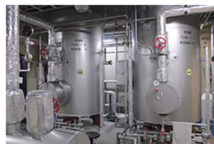
水温を55度で維持できる貯湯槽（2基）
