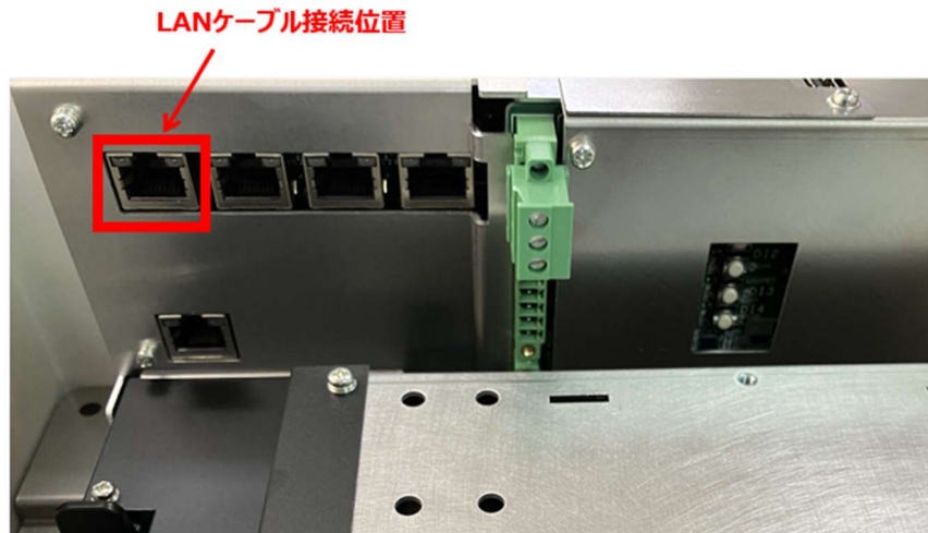
図 5-5 LAN ケーブル接続位置
