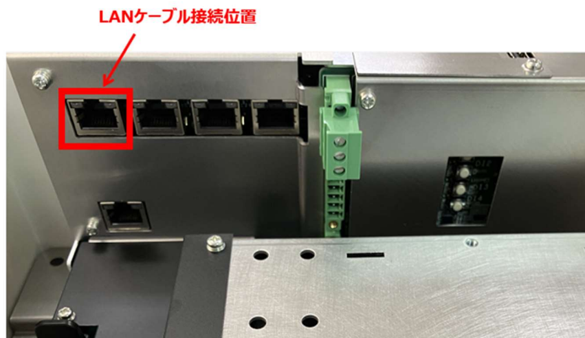
図 3-3 LAN ケーブル接続位置
